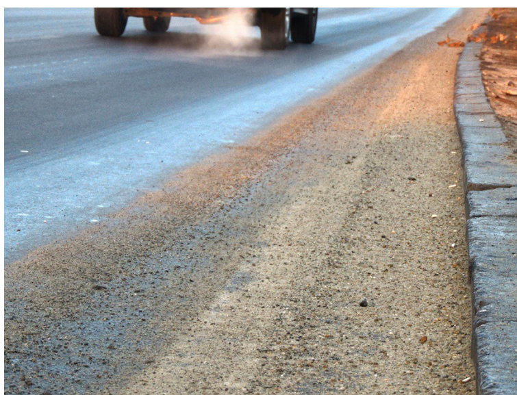
Figura 100. Mizeria care se adună în zona de circulație a bicicletelor scade aderența pneurilor și pune în pericol utilizatorii de biciclete și trotinete electrice
